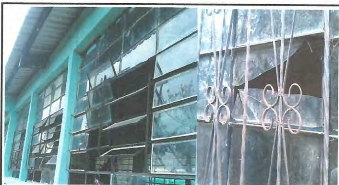
Foto 4: Se realizará el cambio los vidrios de los ventanales debido a que se encuentran quebrados.
