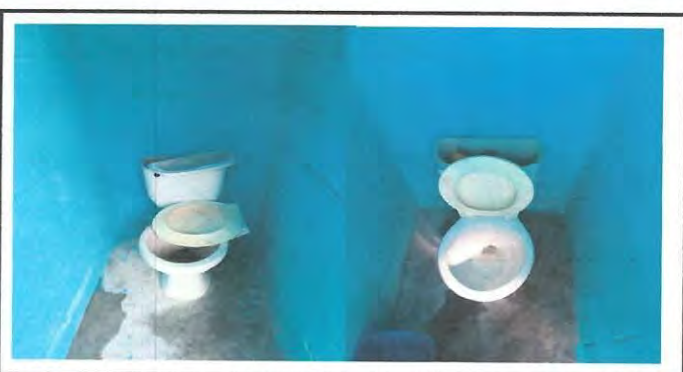
Foto 6: Se realizará el cambio de tasas sanitarias, debido a que se encuentran en mal estado.
