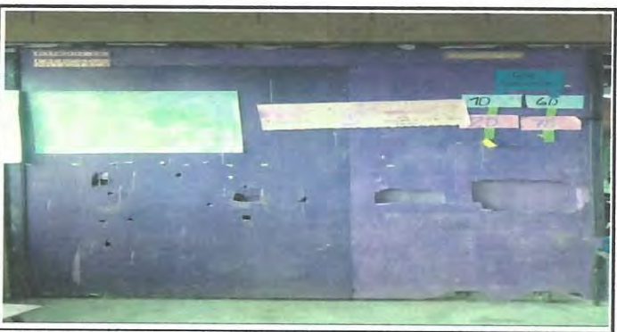
Foto 5: Se realizará cambio de la puerta corrediza que divide las dos aulas debido a que se encuentra en mal estado.
