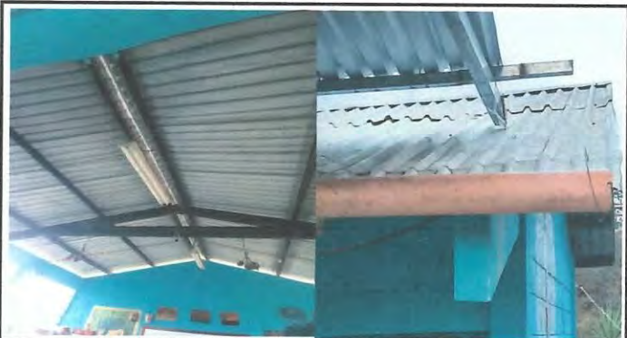
Foto 3: Se realizará el cambio de lámina debido a que se encuentra en mal estado y tiene muchas goteras.
