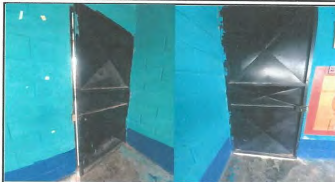
Foto 2: Se realizará cambio de puertas debido a que se encuentran en mal estado.
